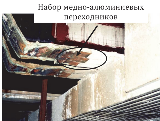
Рис. 7. Внешний вид базовых медно-алюминиевых переходников узла токоподвода к электролизеру каустической соды применяемых на ОАО «Каустик»
